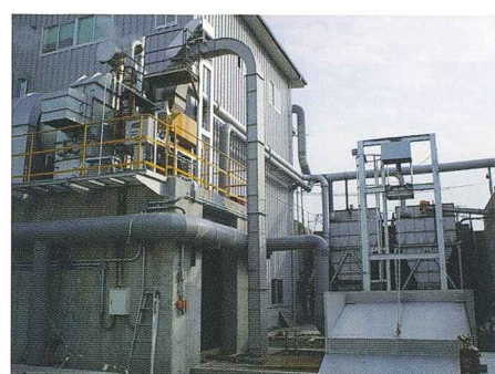
汚泥ホッパー・スネークコンベヤ
