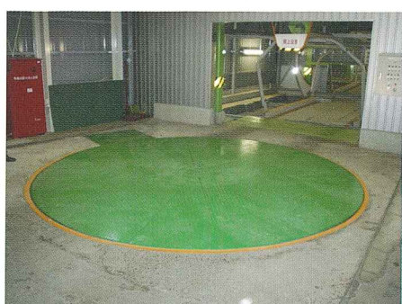
立駐ターンテーブル
